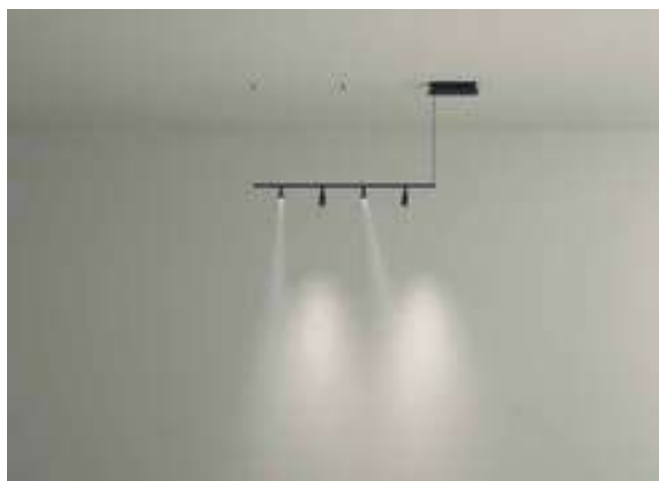
Instalación en superficie. Instalação de superfície.
